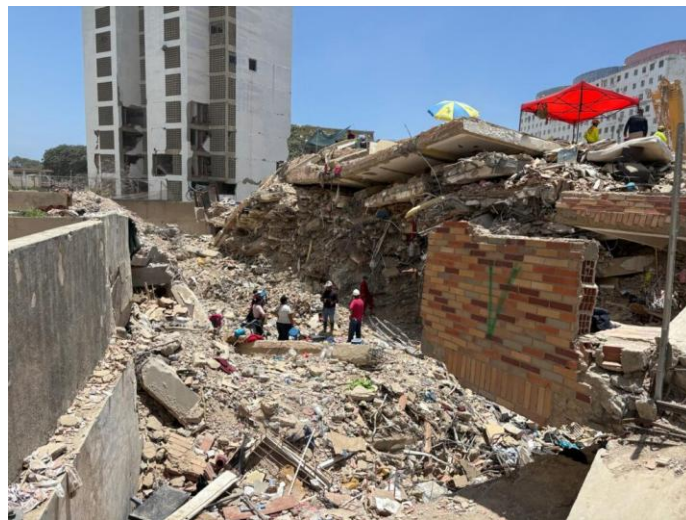
Erdbebenschäden im Küstenstaat La Guaira in Venezuela
